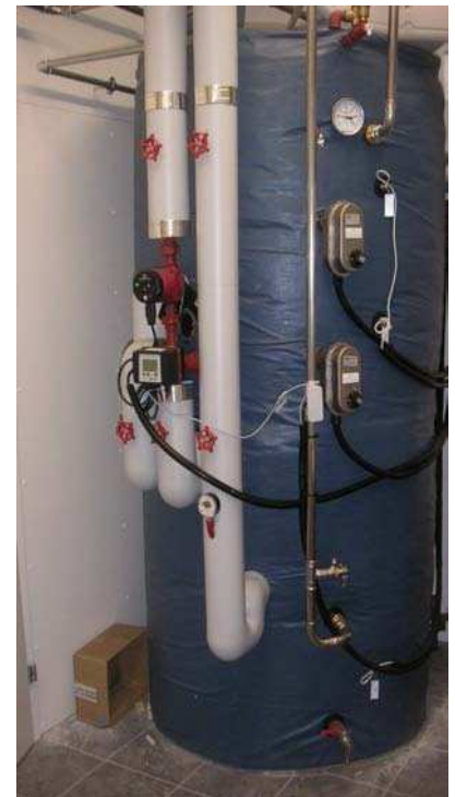
Der gedämmte Jenni-Speicher in einer Migrolino-Tankstelle.
